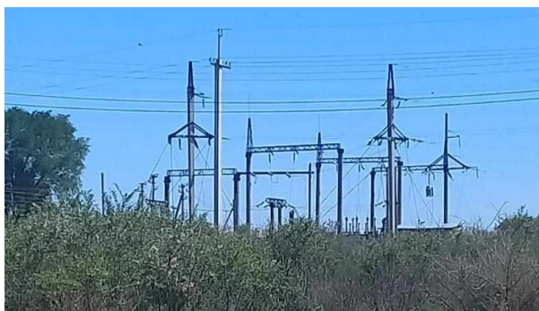
Рисунок 2.2.8. Действующая трансформаторная подстанция.
